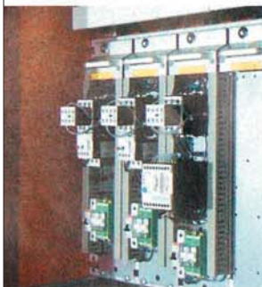
Bild 2. Sicherungslastschalter und Abgangsmodulen
